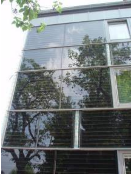
Figur 21. Solfångarfasad på Dieselweg, Dieselweg, Graz (Reference: AEE INTEC).
