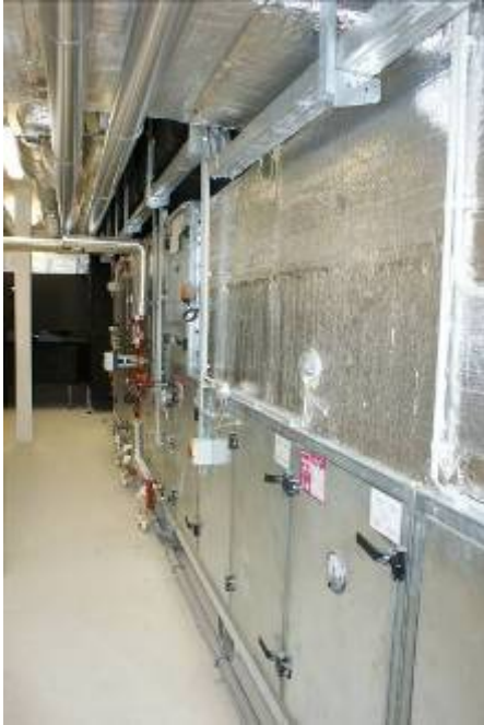
Figur 25. Stort ventilationsaggregat med integrerad värmeåtervinning; AEE INTEC.
