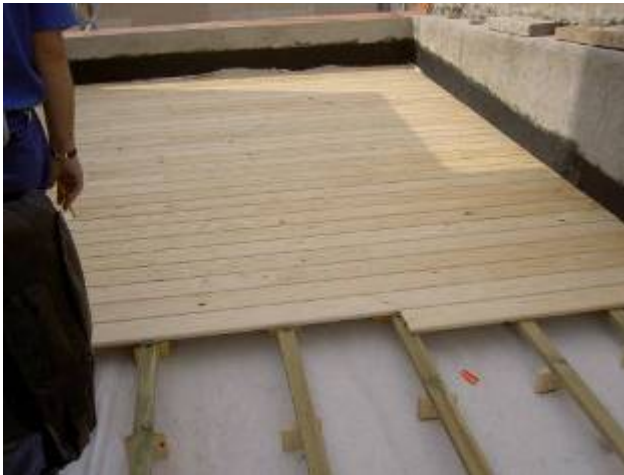
Figur 15. Ventilerat tak i det spanska pilot-projektet St Joan de Malta/Barcelona; TTA.
